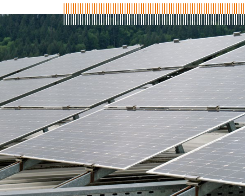
Die Fördermöglichkeiten bei Photovoltaik sind vielfältig.
