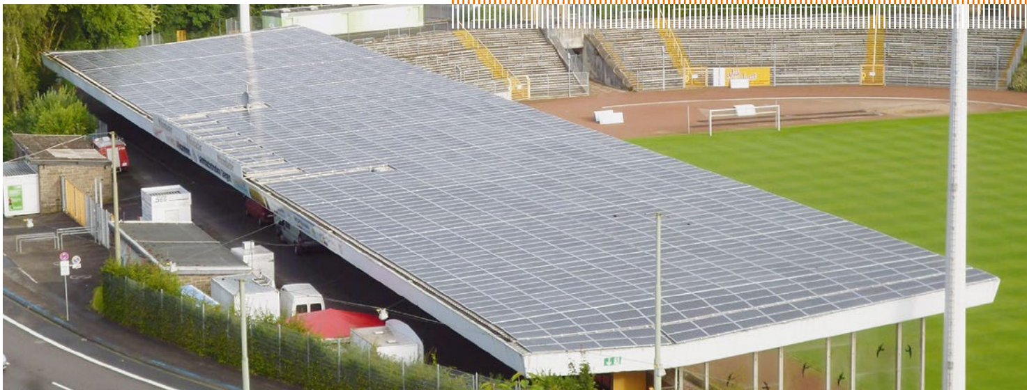
Die Photovoltaik-Anlage auf dem Tribürendach des Leimbachstadions produziert etwa 480.000 Kilowattstunden Strom im Jahr.
