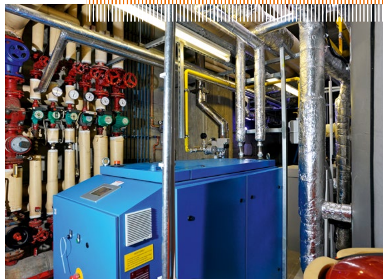
Der TSC nutzt seit 2009 ein Blockheizkraftwerk als Energiequelle.
